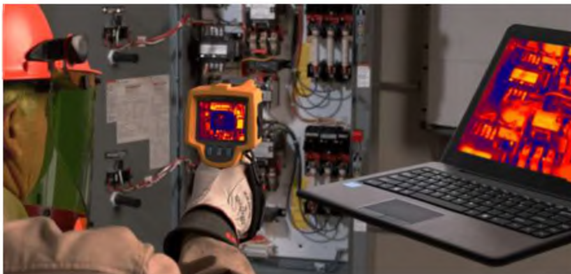
Рисунок 20. Пример проведения тепловизионного контроля электрошкафа
