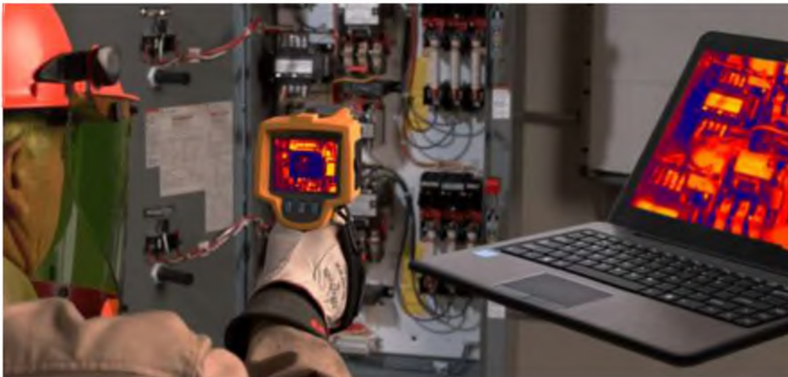
Рисунок 20. Пример проведения тепловизионного контроля электрошкафа
